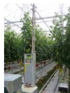
Appareil de traitement sous serres
